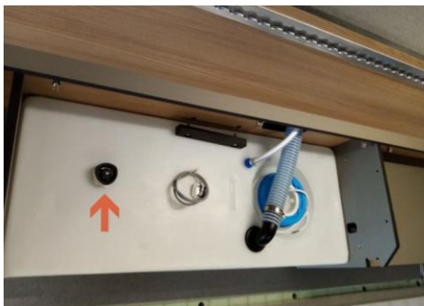
Verbindungsventil Tank innen
